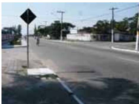
PGR03PON05FOT01 - Microdrenagem obstruída
