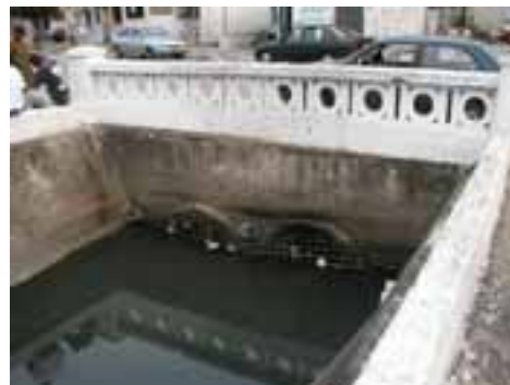
SAN04PON11FOT02 - Sistema de comporta assoreado e obstruído
