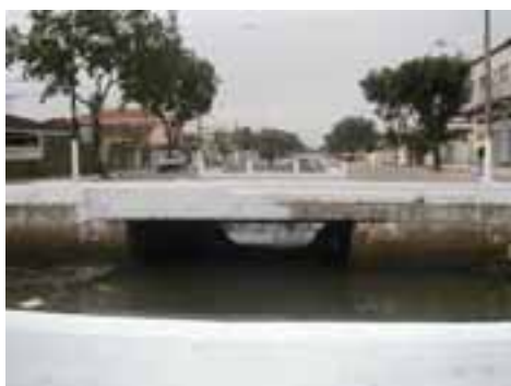
SAN06PON18FOT01 - Canal existente na Av. Jovino Mello com assoreamento
