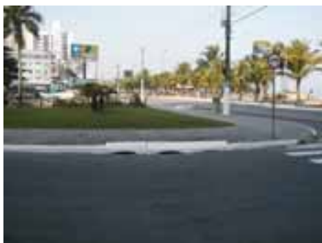
PGR31PON66FOT01 - Microdrenagem obstruída e insuficiente
