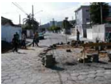
PGR33PON70FOT03 - Microdrenagem obstruída e assoreada
