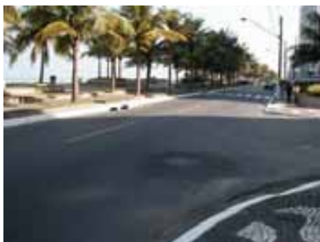
PGR12PON28FOT01 - Microdrenagem obstruída e assoreada
