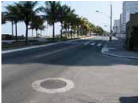
PGR17PON36FOT01 - Microdrenagem obstruída e assoreada
