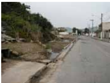
SAN05PON12FOT02 - Sistema de microdrenagem insuficiente e afetado pela maré
