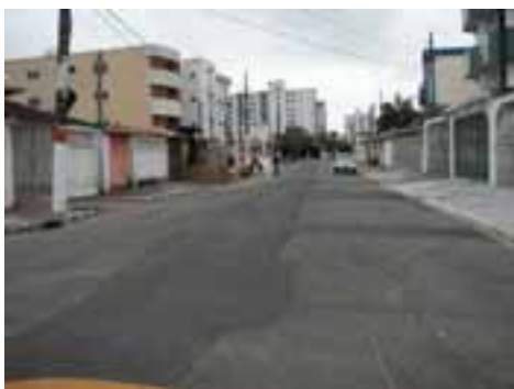
PGR23PON45FOT01 - Microdrenagem obstruída e insuficiente
