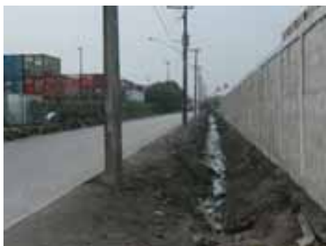
SAN01PON02FOT02 - Sistema de microdrenagem insuficiente e inadequado
