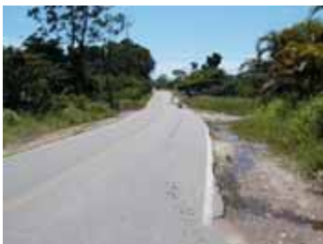
PER21PON50FOT01 - Inexistência de Microdrenagem no Ponto Baixo
