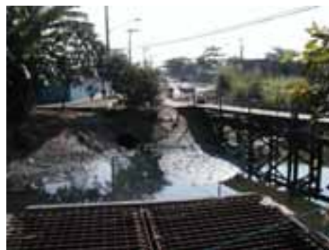
SAN03PON08FOT01 - Sistema de comporta assoreado e obstruído
