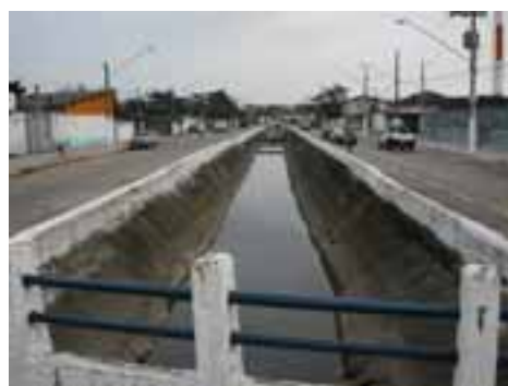
SAN07PON22FOT03 - Canal existente na Av. Hugo Maia com assoreamento
