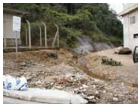
SAN05PON13FOT02 - Base do morro do Ilhéu com drenagem insuficiente
