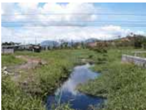
PER23PON53FOT01 - Canal Existente Assoreado e Insuficiente
