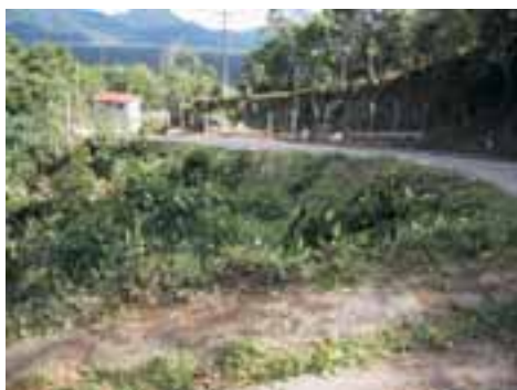
PER20PON45FOT01 - Trecho em curva da estrada do Guarau com talude desprovido de drenagem.
