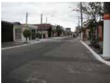
PGR16PON35FOT01 - Microdrenagem obstruída e insuficiente
