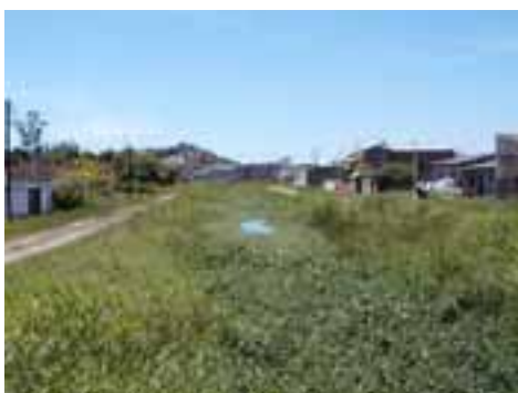
PER22PON52FOT01 - Canal Existente Assoreado e Insuficiente
