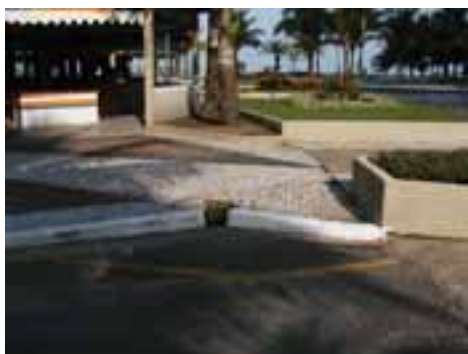
PGR31PON67FOT01 - Microdrenagem obstruída e insuficiente
