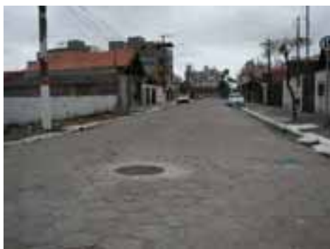
PGR21PON40FOT01 - Microdrenagem obstruída e insuficiente
