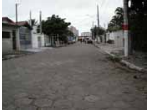
PGR26PON48FOT01 - Microdrenagem obstruída e insuficiente
