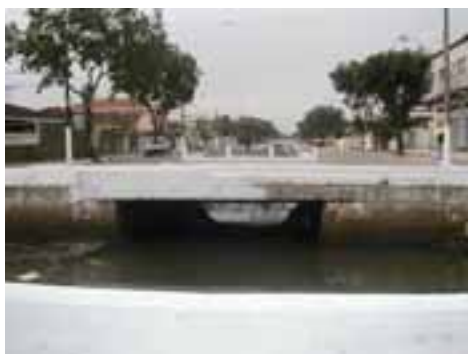
SAN06PON16FOT02 - Canal existente na Av. Jovino Mello com assoreamento
