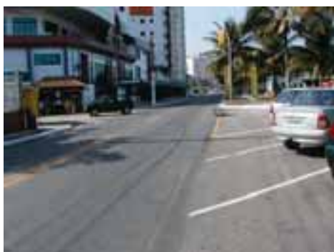
PGR09PON23FOT01 - Microdrenagem obstruída e insuficiente
