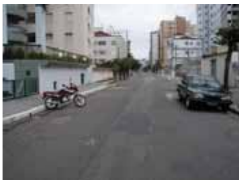
PGR13PON29FOT02 - Microdrenagem obstruída e assoreada
