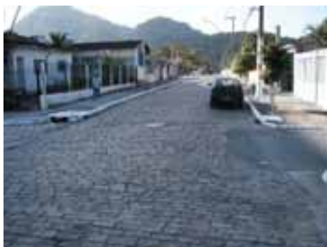
SVI37PON75FOT02 - Microdrenagem obstruída e insuficiente
