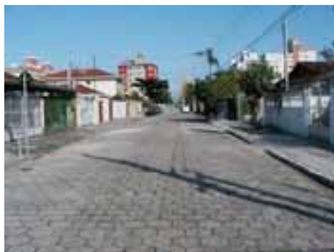
PGR33PON70FOT01 - Microdrenagem obstruída e assoreada
