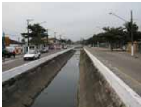
SAN07PON22FOT01 - Canal existente na Av. Hugo Maia com assoreamento
