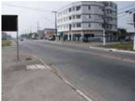
PGR06PON14FOT01 -Microdrenagem assoreada e insuficiente
