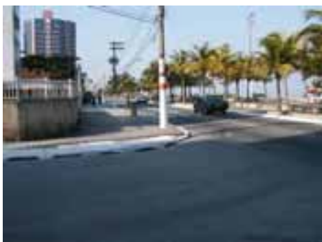
PGR25PON47FOT01 - Microdrenagem obstruída e assoreada
