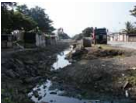
SAN04PON09FOT01 - Vala existente assoreada
