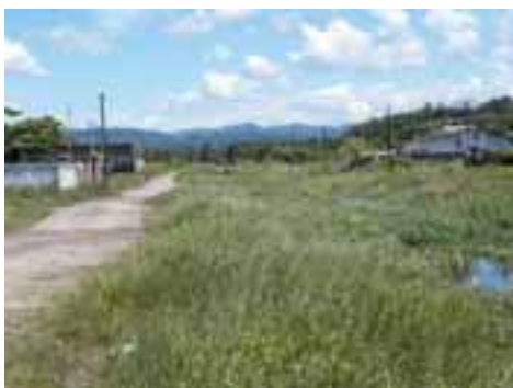
PER22PON51FOT01 - Canal Existente Assoreado e Insuficiente
