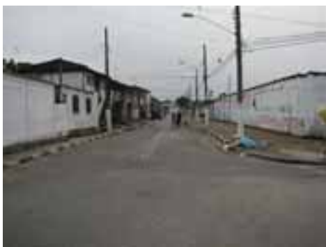
SAN04PON11FOT01 - Viário com microdrenagem insuficiente
