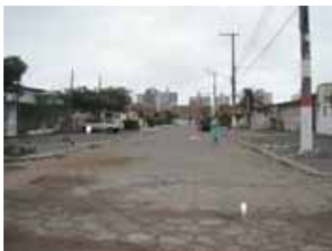
PGR27PON49FOT01 - Microdrenagem obstruída e insuficiente
