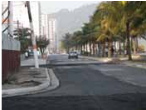
PGR35PON72FOT02 - Microdrenagem obstruída e assoreada
