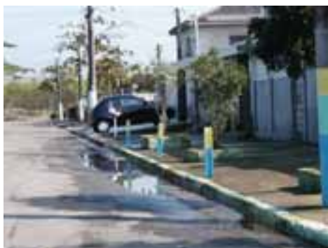
SAN03PON07FOT02 - Viário com microdrenagem insuficiente
