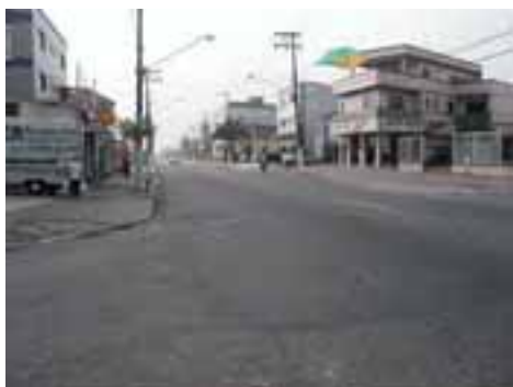
PGR11PON27FOT01 - Microdrenagem obstruída e insuficiente
