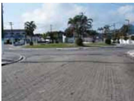
PGR30PON57FOT02 - Microdrenagem obstruída e assoreada
