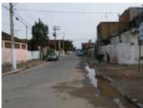
SAN05PON15FOT01 - Sistema de microdrenagem insuficiente e afetado pela maré
