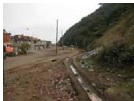
SAN05PON15FOT04 - Base do morro do Ilhéu com drenagem insuficiente
