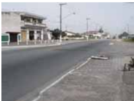
PGR05PON13FOT01 - Microdrenagem obstruída e assoreada
