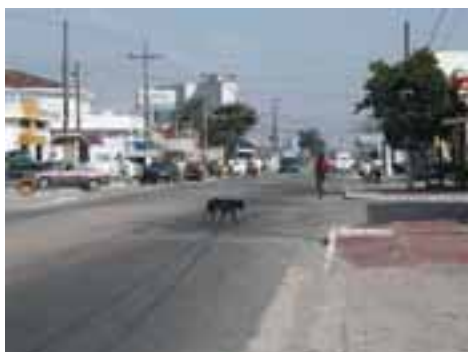
PGR08PON22FOT02 -Microdrenagem obstruída e insuficiente
