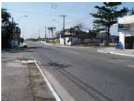
PGR01PON01FOT01 - Microdrenagem obstruída e assoreada
