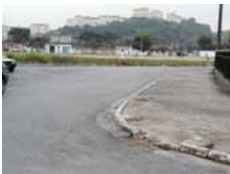
SAN07PON21FOT02 - Sistema de microdrenagem insuficiente e afetado pela maré
