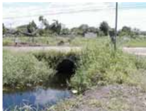
PER23PON53FOT02 - Inexistência de Microdrenagem
