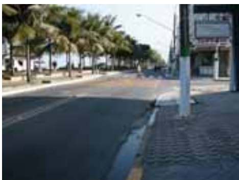
PGR14PON31FOT01 - Microdrenagem obstruída e assoreada
