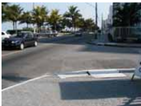
SVI19PON38FOT01 - Microdrenagem obstruída e insuficiente
