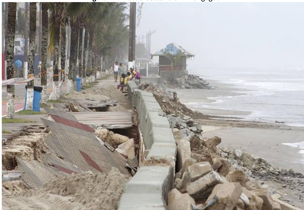
Figura 4 - Erosão Costeira em Mongaguá.
