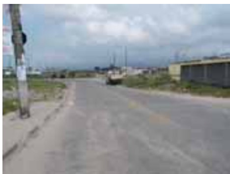
SVI89PON164FOT03 - Viário com microdrenagem insuficiente
