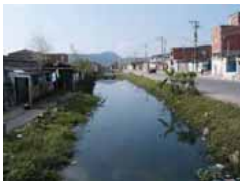
SVI93PON170FOT02 - Canal existente obstruído e assoreado
