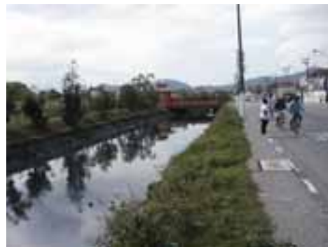
SVI94PON172FOT01 - Canal lateral ao viário obstruído e assoreado
