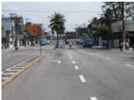
SVI97PON175FOT02 - Viário com microdrenagem insuficiente
