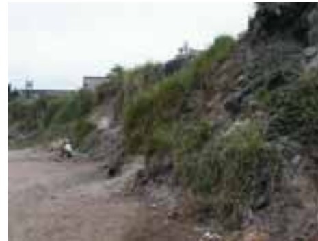
SVI88PON163FOT02 - Talude ao longo da rua "G" apresentando erosão e colocando em risco a habitações localizadas na parte superior do talude
