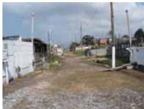
SVI90PON166FOT01 - Viário com microdrenagem inexistente
