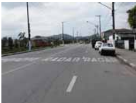
SVI94PON172FOT03 - Viário com microdrenagem insuficiente
