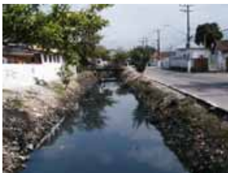
SVI95PON173FOT02 - Canal lateral ao viário sem revestimento adequado
