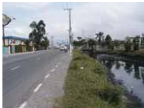
SVI94PON172FOT02 - Canal lateral ao viário obstruído e assoreado
