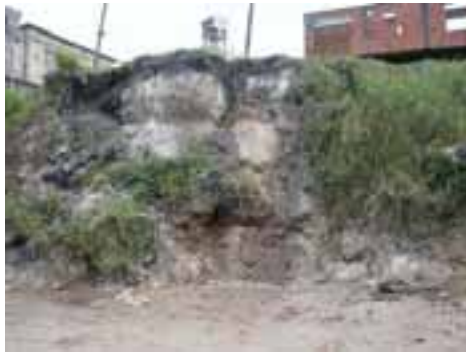
SVI88PON163FOT01 - Detalhe da erosão indicando solo arenoso constituente de talude
