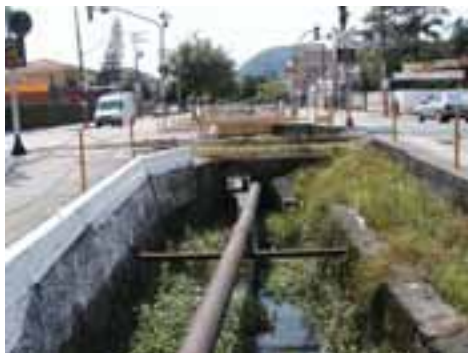
SVI98PON177FOT03 - Canal existente obstruído e assoreado
