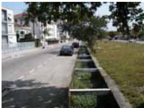
SVI98PON177FOT01 - Canal existente obstruído e assoreado
