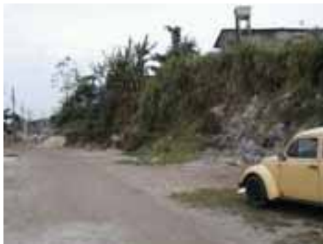
SVI88PON163FOT04 - Talude ao longo da rua apresentando erosão e colocando em risco a habitações localizadas na parte superior do talude, Observar habitações ocupando área irregular localizada entre a rua "G" e o Rio Negro
