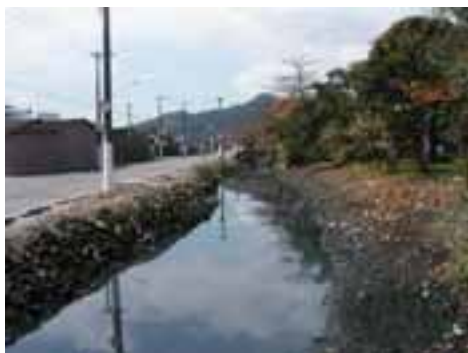
SVI95PON173FOT01 - Canal lateral ao viário sem revestimento adequado
