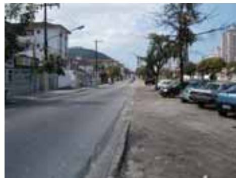
SVI98PON176FOT03 - Viário com microdrenagem insuficiente
