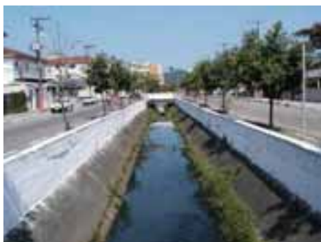
SVI99PON179FOT02 - Canal existente obstruído e assoreado
