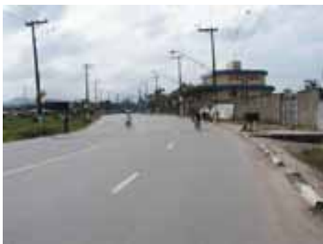
SVI94PON182FOT01 - Viário com microdrenagem insuficiente
