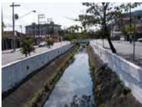
SVI99PON179FOT01 - Canal existente obstruído e assoreado
