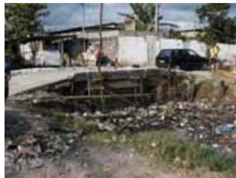
SVI24PON44FOT02 - Canal natural assoreado com travessia obstruída
