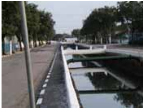
SAN11PON28FOT04 - Canal existente assoreado
