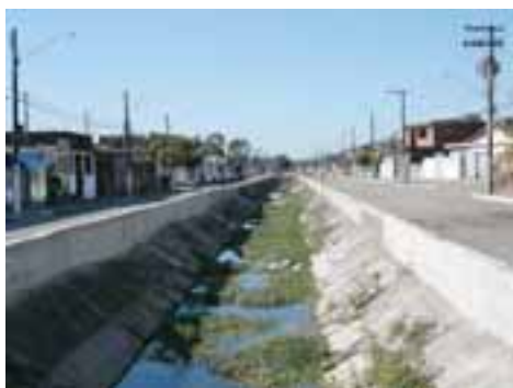
SVI11PON22FOT02 - Canal entre viário existente, assoreado
