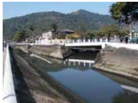
SAN17PON34FOT02 - Canal existente assoreado
