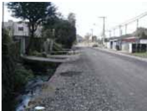
SAN40PON69FOT01 - Canal lateral ao viário, assoreado e obstruído
