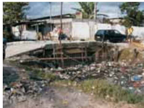
SVI24PON44FOT02 - Canal natural assoreado com travessia obstruída
