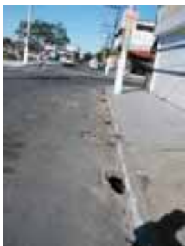
SVI15PON31FOT01 - Viário com microdrenagem insuficiente
