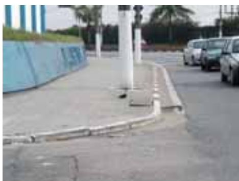
SAN18PON39FOT03 - Sistema de microdrenagem insuficiente e obstruído
