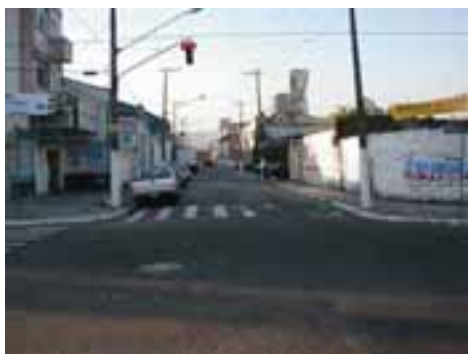
SAN30PON56FOT02 - Sistema de microdrenagem danificado e obstruído
