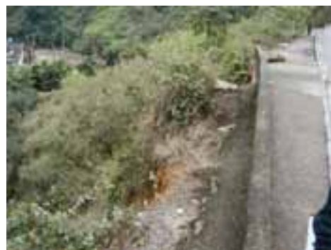
SAN21PON42FOT02 - Detalhe da erosão da encosta junto a escada hidráulica.
