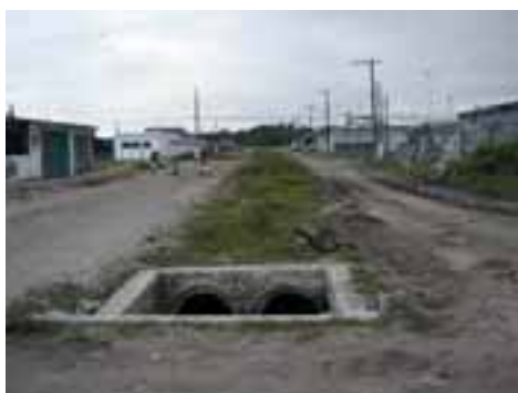
SVI02PON06FOT02 - Galeria tubular existente insuficiente
