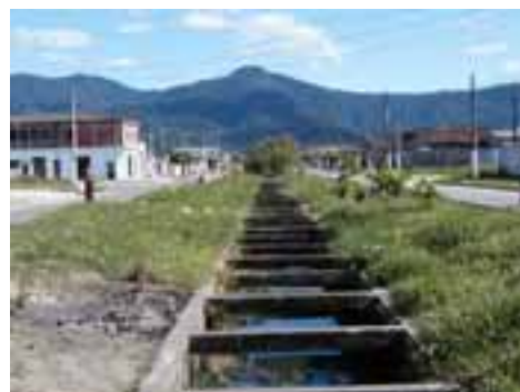
SVI12PON27FOT01 - Trecho em canal a céu aberto, assoreado
