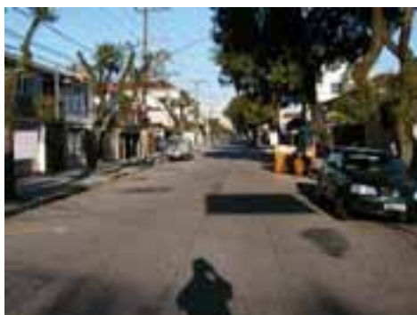
SAN37PON64FOT01 - Viário com ausência de microdrenagem
