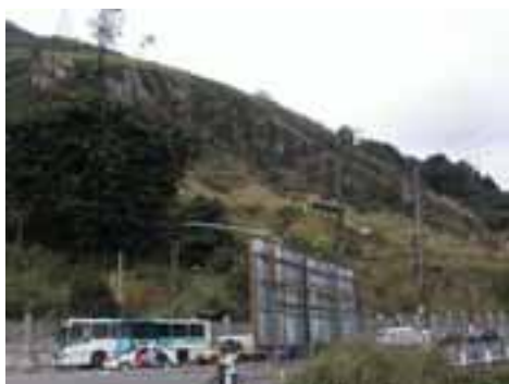
SAN23PON46FOT01 - Vista da encosta do Morro Caneleira com blocos de rocha apresentando risco para via.
