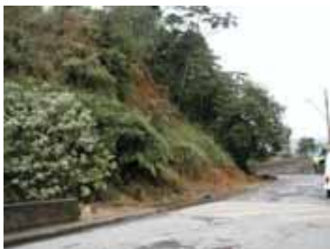
SAN21PON40FOT01 - Encosta apresentando solo com deslizamento sobre calçada e via.
