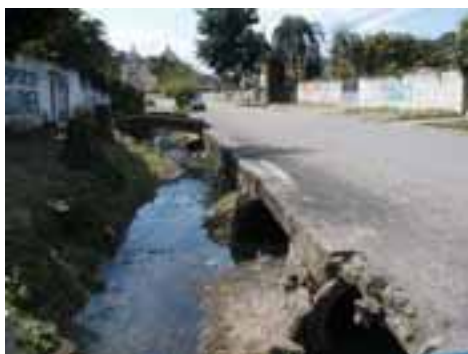
SAN40PON70FOT02 - Canal lateral ao viário, assoreado e obstruído
