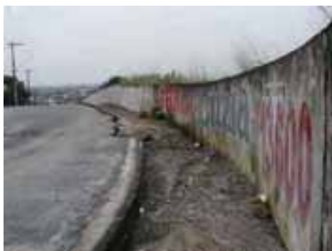
SAN19PON43FOT01 - Erosão de borda de pavimento por falta de galeria de coleta de águas pluviais.
