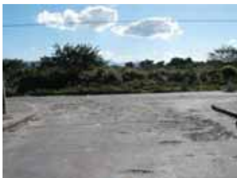
SVI19PON35FOT01 - Viário com microdrenagem inexistente
