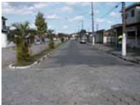
SVI25PON46FOT01 - Viário com microdrenagem assoreada e obstruída
