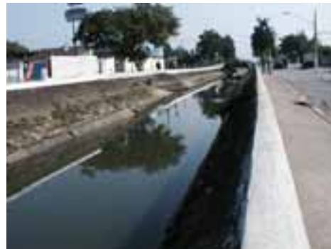
SAN17PON34FOT06 - Canal existente assoreado
