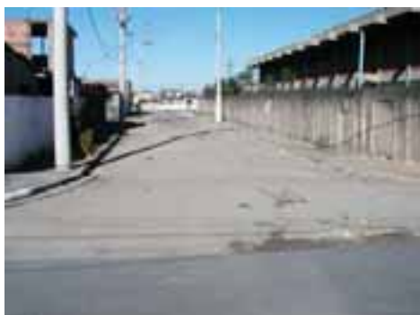
SVI17PON33FOT02 - Viário com microdrenagem inexistente
