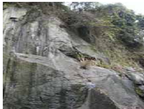
SAN28PON54FOT09 - Detalhe da encosta indicando os diversos planos de fraturamentos da rocha.
