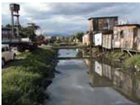
SVI24PON43FOT01 - Canal natural assoreado com travessia obstruída
