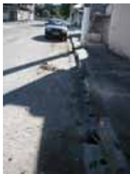
SVI14PON28FOT03 - Viário com microdrenagem insuficiente
