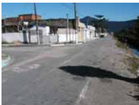
SVI19PON35FOT02 - Viário com microdrenagem inexistente
