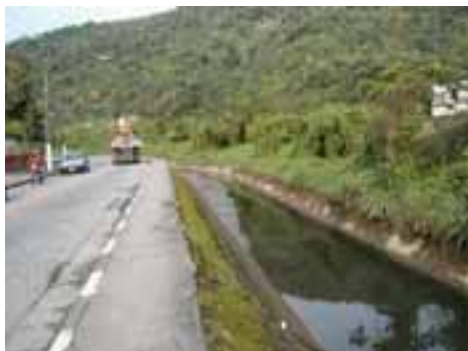
SAN17PON37FOT01 - Canal existente deteriorado
