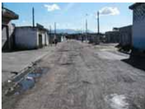
SVI14PON30FOT01 - Viário com microdrenagem insuficiente
