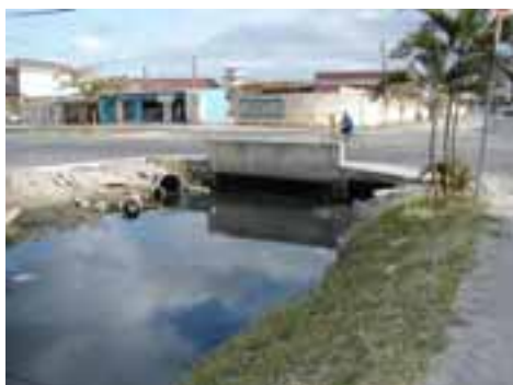
SVI23PON41FOT01 - Lançamento da galeria obstruída e assoreada devido ao canal que pertence a área SVI24.
