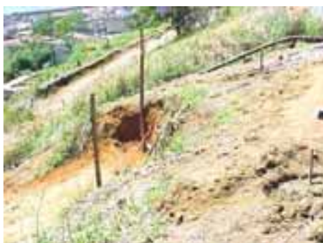
FOTO DA DEFESA CIVIL - Detalhe da área com deslizamento sobre via (Imagem extraída do relatório "Obras Defesa Civil 6 - PARTE 6").
