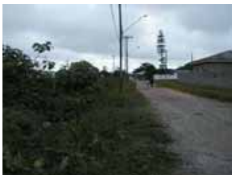
SVI09PON18FOT01 - Viário em terra sem microdrenagem
