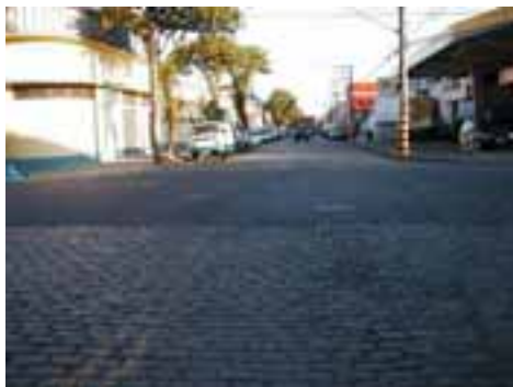
SAN39PON68FOT02 - Sistema de microdrenagem insuficiente e obstruído
