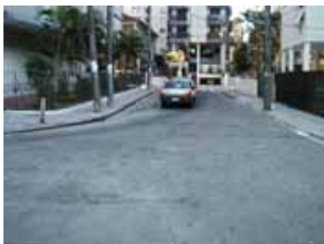
SAN35PON62FOT02 - Sistema de microdrenagem insuficiente e obstruído
