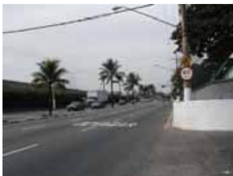
SAN18PON39FOT02 - Sistema de microdrenagem insuficiente e obstruído
