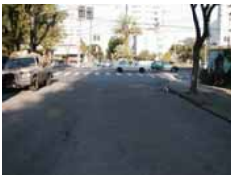
SAN37PON65FOT01 - Viário com ausência de microdrenagem
