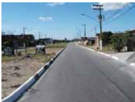
SVI12PON26FOT01 - Viário com galeria no canteiro central e microdrenagem insuficiente
