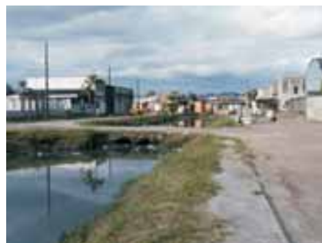
SVI24PON45FOT02 - Canal natural assoreado com travessia obstruída
