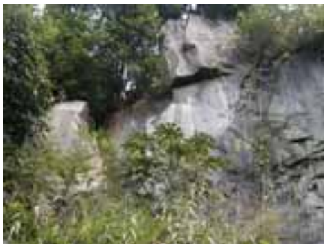
SAN28PON54FOT02 - Vista do detalhe do bloco com risco de deslizamento.
