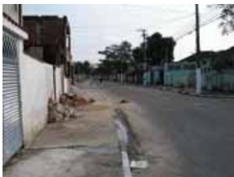
SAN16PON33FOT01 - Sistema de microdrenagem insuficiente e afetado pelo lançamento
