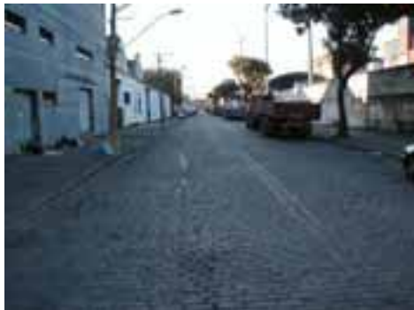
SAN39PON68FOT01 - Sistema de microdrenagem insuficiente e obstruído
