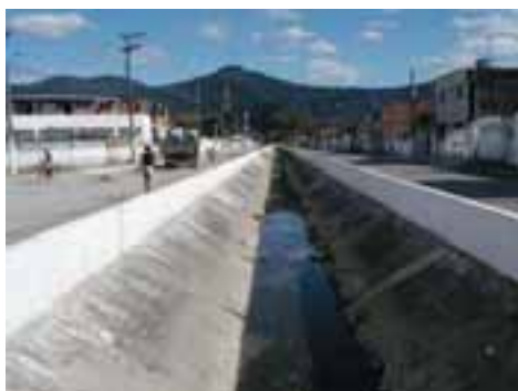
SVI11PON21FOT02 - Canal entre viário existente, assoreado
