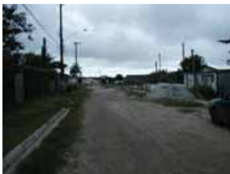
SVI09PON17FOT02 - Viário em terra sem microdrenagem
