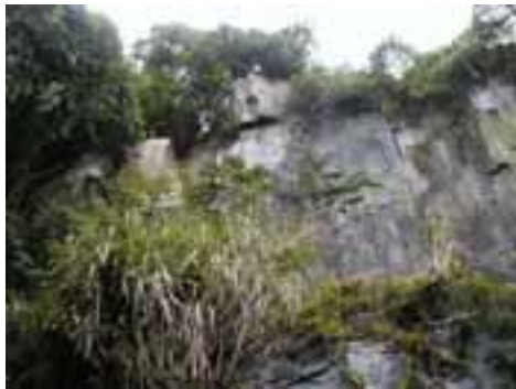
SAN28PON54FOT01 - Encosta do Monte Serrat com bloco em risco de deslizamento sobre instalações do Corpo de Bombeiros de Santos.
