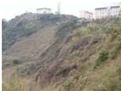
SAN20PON44FOT02 - Encosta apresentando área de deslizamento/erosão. Via interna do condomínio situada no topo da encosta.
