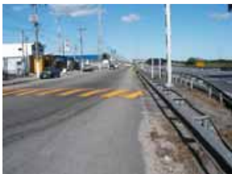
SVI10PON19FOT01 - Microdrenagem existente insuficiente
