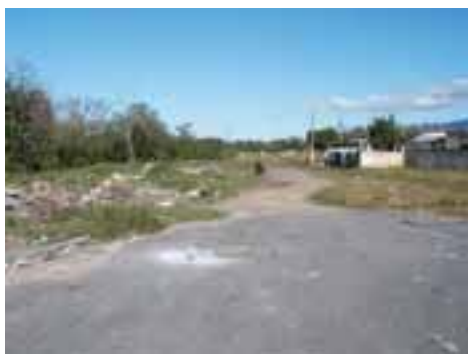
SVI21PON36FOT02 - Viário em terra sem microdrenagem
