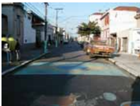
SAN38PON66FOT02 - Sistema de microdrenagem insuficiente e obstruído
