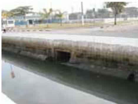
SAN11PON28FOT05 - Canal existente assoreado
