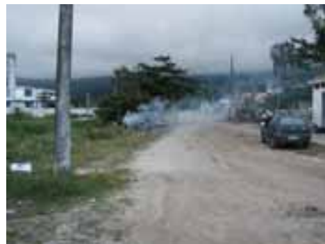
SVI01PON04FOT01 - Viário em terra sem microdrenagem
