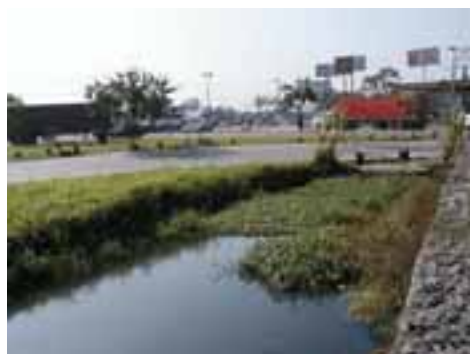
SAN13PON30FOT01 - Canal assoreado e obstruído, afetado também pela maré
