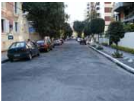
SAN34PON61FOT01 - Sistema de microdrenagem insuficiente e obstruído
