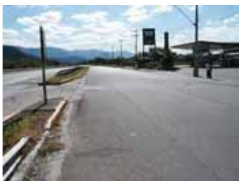
SVI10PON19FOT02 - Microdrenagem existente insuficiente
