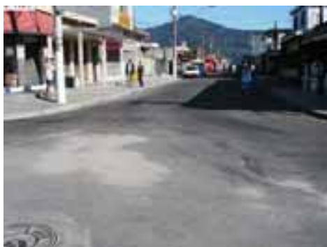
SVI15PON31FOT03 - Viário com microdrenagem insuficiente
