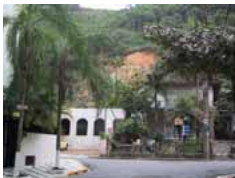
GUA24PON64FOT01 - Encosta do morro do Pitu situado atrás de casas e edifícios na região central de Guarujá apresentando deslizamento / erosão de solo na encosta
