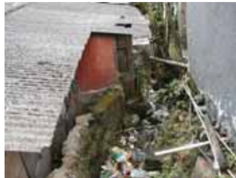
GUA07PON28FOT02 - Detalhe dos barracos e lixo, obstruindo a drenagem da encosta.
