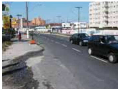
GUA48PON140FOT02 - Viário com microdrenagem insuficiente
