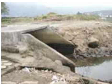
CUB19PON47FOT01 - Bairro com microdrenagem insuficiente e lançamento afetado pela maré
