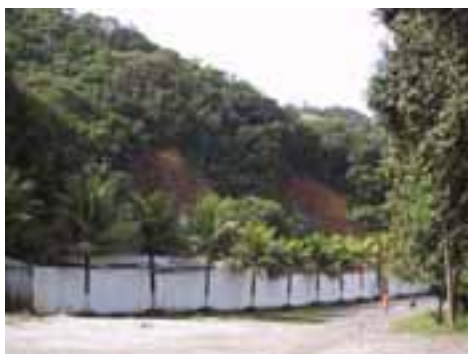
GUA29PON72FOT01 - Erosão da encosta do morro de Santo Amaro em área de empréstimo desativada
