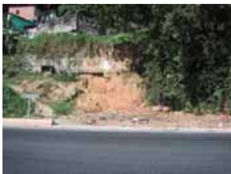
GUA16PON53FOT04 - Talude apresentando escoamento de solo junto à pista da Estrada Pernambuco.
