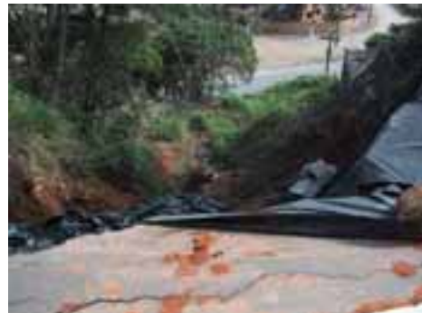
GUA33PON79FOT02 - Detalhe do deslizamento, observar ao fundo parte da pista da entrada Pernambuco
