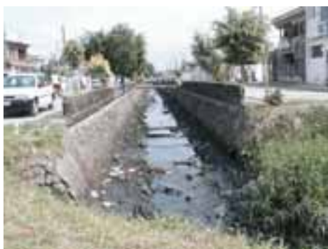
GUA03PON98FOT01 - Canal existente assoreado e obstruído
