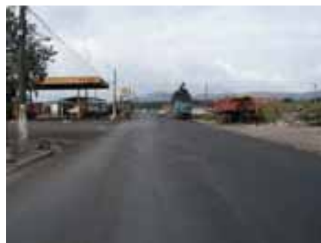
GUA43PON127FOT01 - Viário com microdrenagem insuficiente
