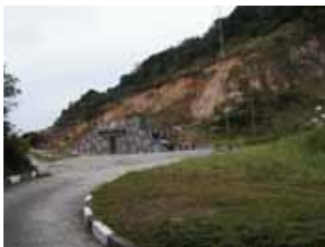
GUA20PON59FOT01 - Vista geral da erosão na encosta do morro
