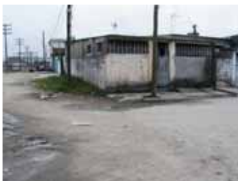
GUA41PON116FOT01 - Viário com micro drenagem insuficiente
