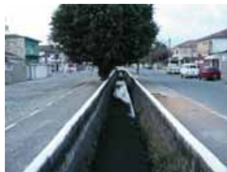
GUA01PON93FOT01 - Canal no canteiro, obstruído e assoreado
