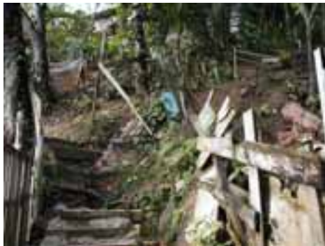
GUA09PON37FOT01 - Vista típica de escada de encosta existente na ocupação. Observar a precariedade de suas condições.
