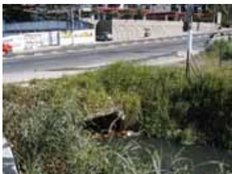
GUA48PON140FOT01 - Canal existente assoreado e obstruído
