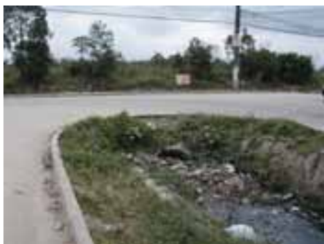
GUA47PON138FOT01 - Canal existente assoreado e obstruído
