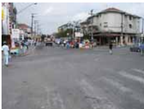
GUA38PON110FOT01 - Viário com microdrenagem insuficiente
