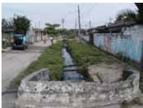
GUA42PON118FOT02 - Vala existente sem tratamento
