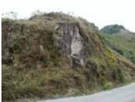
GUA06PON20FOT01 - Maciço de rocha/solo junto a Estrada Municipal Gaiúba, apresentando riscos de deslizamento de solo e/ou deslocamento de rocha sobre a entrada.
