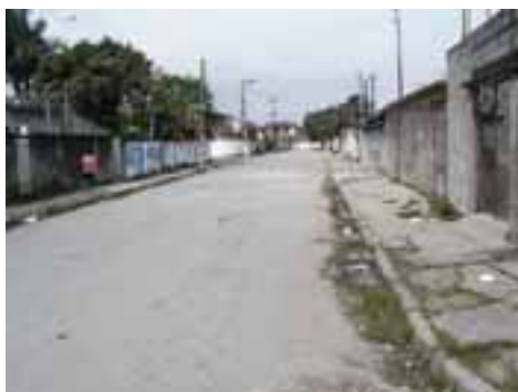
GUA03PON100FOT01 - Viário com microdrenagem insuficiente
