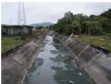
GUA43PON123FOT01 - Canal existente assoreado e obstruído
