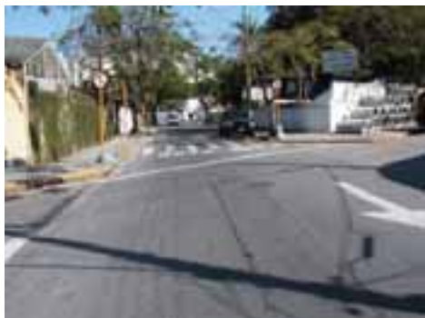
GUA45PON130FOT01 - Viário com microdrenagem insuficiente
