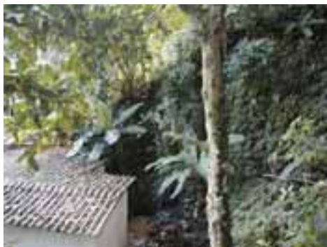
GUA12PON46FOT02 - Detalhe de barraco no pé de talude com risco de deslizamento do talude sobre o mesmo.
