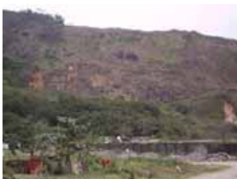
GUA23PON63FOT02 - Erosão da encosta do morro do Pitu em área de empréstimo desativada. Observar matacões na encosta
