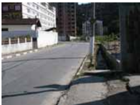
GUA49PON143FOT01 - Canal existente assoreado e obstruído
