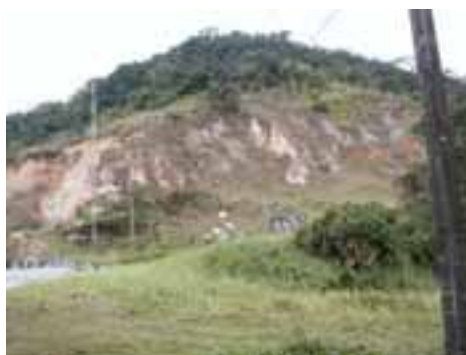
GUA20PON59FOT02 - Vista geral da erosão na encosta do morro
