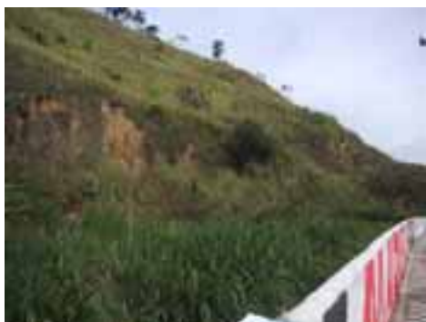
GUA31PON75FOT02 - Erosão de encosta do morro próximo da Av. Dep. Emílio Carlos
