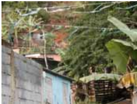
GUA11PON42FOT01 - Detalhe de encosta com indicação de ação antrópica (corte de talude) junto ao barraco.
