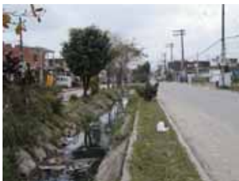
GUA47PON137FOT01 - Canal existente assoreado e obstruído
