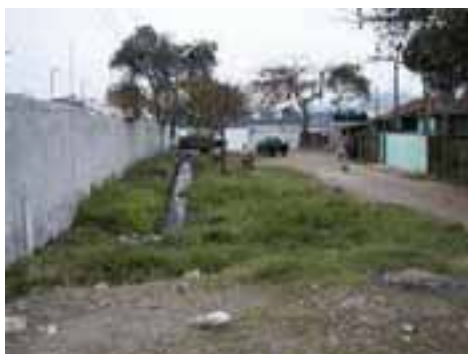
GUA39PON112FOT01 - Lançamento de microdrenagem inadequado
