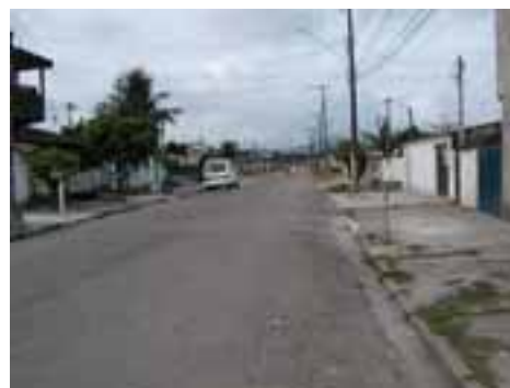
GUA43PON126FOT01 - Viário com microdrenagem insuficiente
