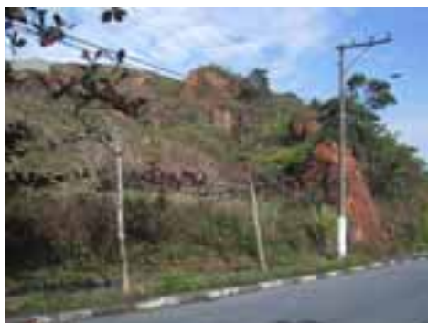
GUA34PON81FOT01 - Área de erosão da encosta do morro. Observar afloramento rochoso
