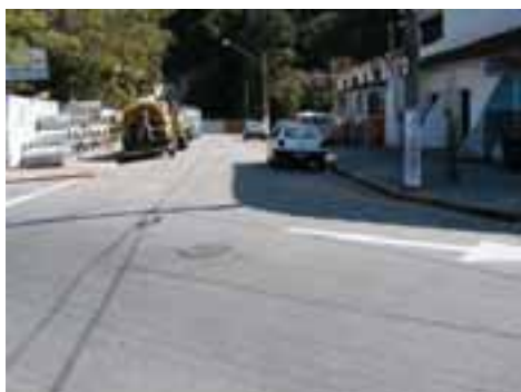
GUA45PON130FOT02 - Viário com microdrenagem insuficiente
