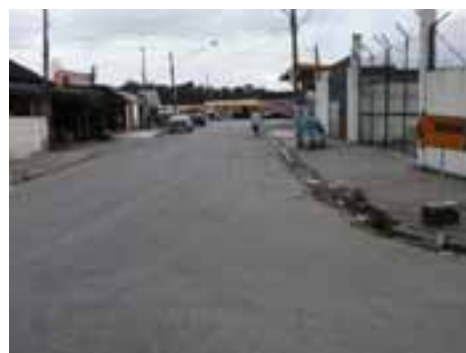
GUA42PON120FOT02 - Viário com microdrenagem insuficiente
