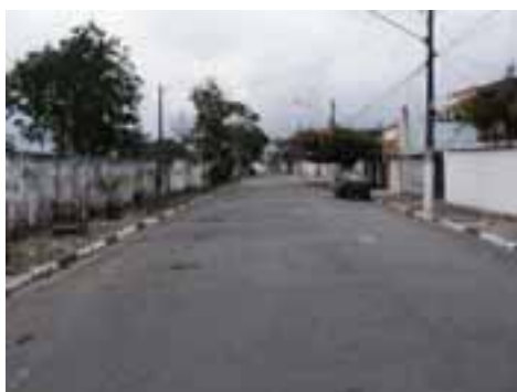
GUA37PON108FOT01 - Viário com microdrenagem insuficiente
