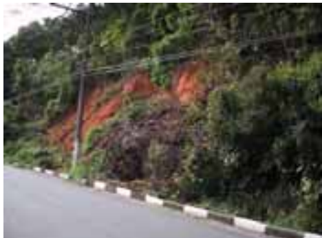
GUA33PON78FOT01 - Área de erosão / deslizamento na encosta do morro junto a pista de acesso ao Sorocotuba
