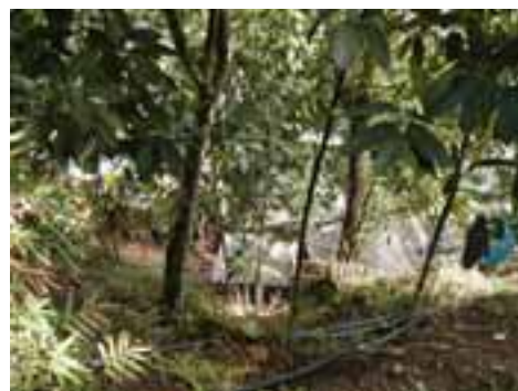
GUA05PON17FOT01 - Casa no pé de talude com risco de deslizamento
