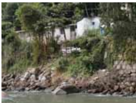
GUA05PON14FOT02 - Talude com deslizamento junto ao mar comprometendo viela.
