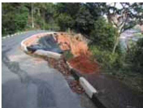
GUA33PON79FOT01 - Deslizamento ocorrido recentemente na encosta juntamente ao trecho da pista de acesso ao Sorocotuba
