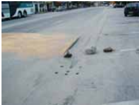
GUA04PON11FOT03 - Viário com microdrenagem insuficiente
