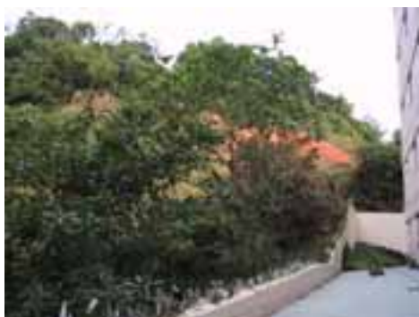
GUA32PON76FOT02 - Erosão / deslizamento de encosta do morro do Stefano localizado no fundo do terreno com edifício na rua Ciro Alves nº 105
