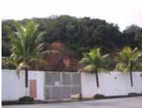
GUA29PON73FOT01 - Erosão da encosta do morro de Santo Amaro em área de empréstimo desativada
