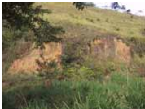
GUA31PON75FOT01 - Erosão de encosta do morro próximo da Av. Dep. Emílio Carlos
