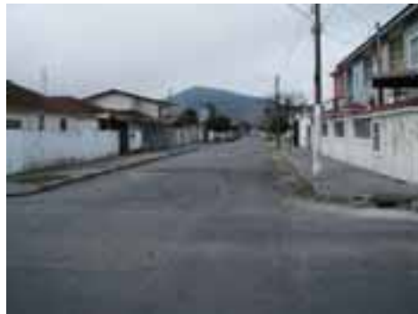
GUA01PON88FOT01 - Viário com microdrenagem assoreada e obstruída
