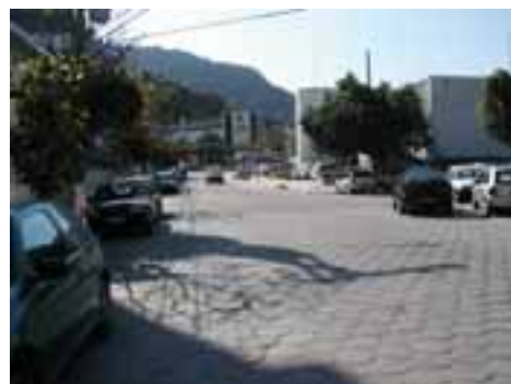
GUA48PON141FOT01 - Viário com microdrenagem insuficiente
