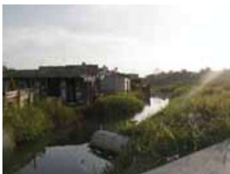
GUA02PON05FOT01 - Canal existente assoreado e obstruído
