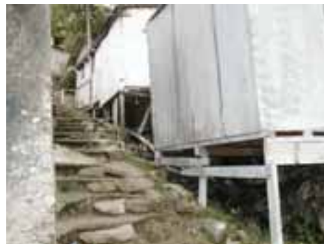
GUA07PON28FOT03 - Detalhe indicando a precariedade e insegurança das construções locais.
