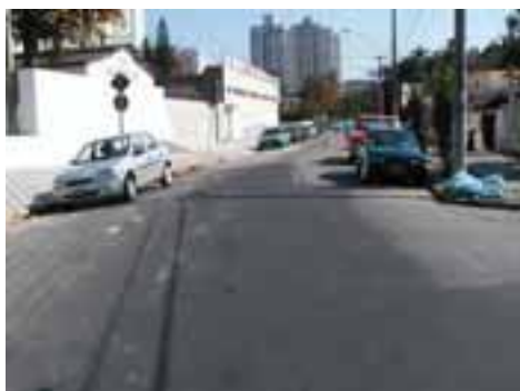
GUA46PON132FOT02 - Viário com microdrenagem insuficiente
