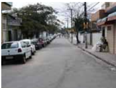
GUA38PON109FOT02 - Viário com microdrenagem insuficiente
