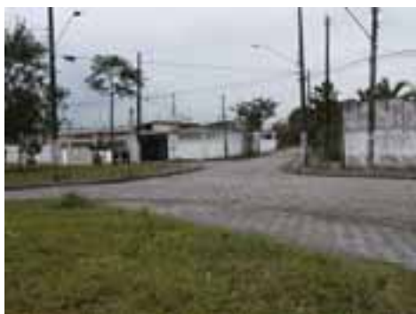
CUB19PON46FOT02 - Bairro com microdrenagem insuficiente e lançamento afetado pela maré
