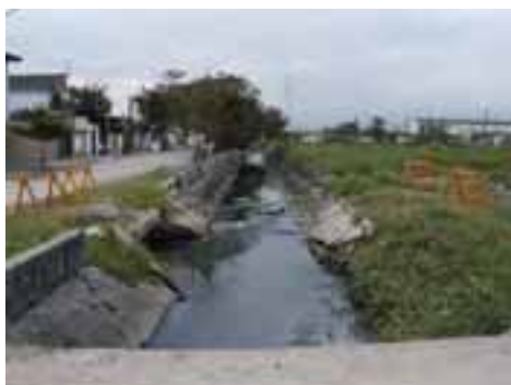
GUA43PON125FOT02 - Canal existente assoreado e obstruído
