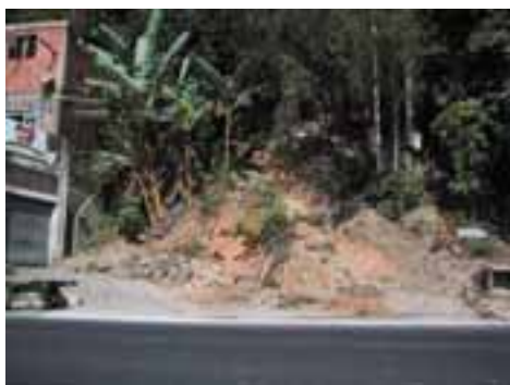
GUA16PON53FOT02 - Talude apresentando escoamento de solo junto à pista da Estrada Pernambuco.
