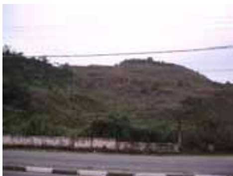
GUA22PON62FOT01 - Erosão na encosta do morro do Pitu
